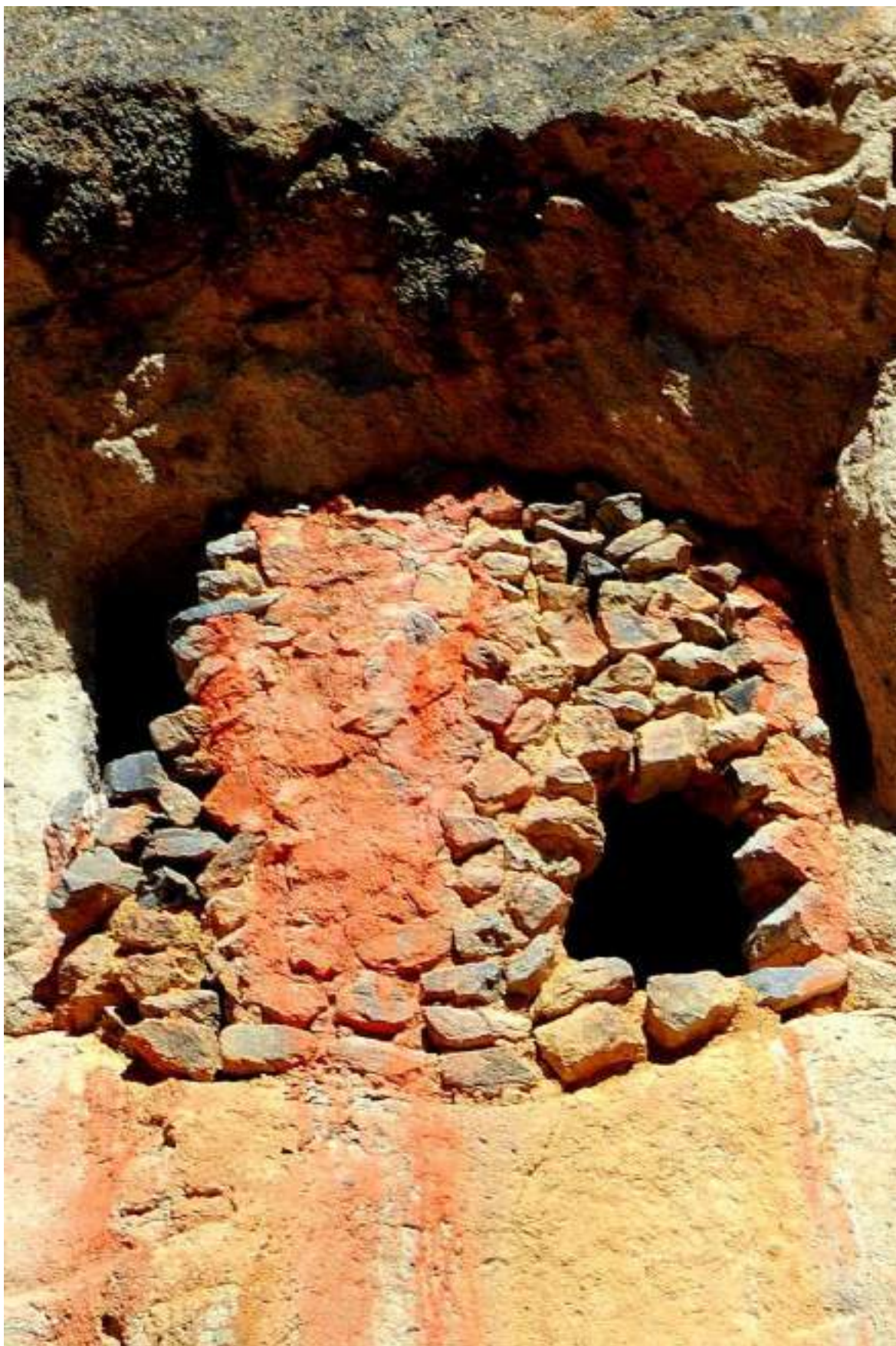
Foto 15 (Arnaldo Ramos). Choquetico, sector III, detalle de la tumba y su entrada. Daño lateral y rajadura central en el muro.
